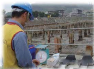
列管場址進行油水分離處理
